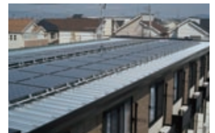
太陽光発電システム
